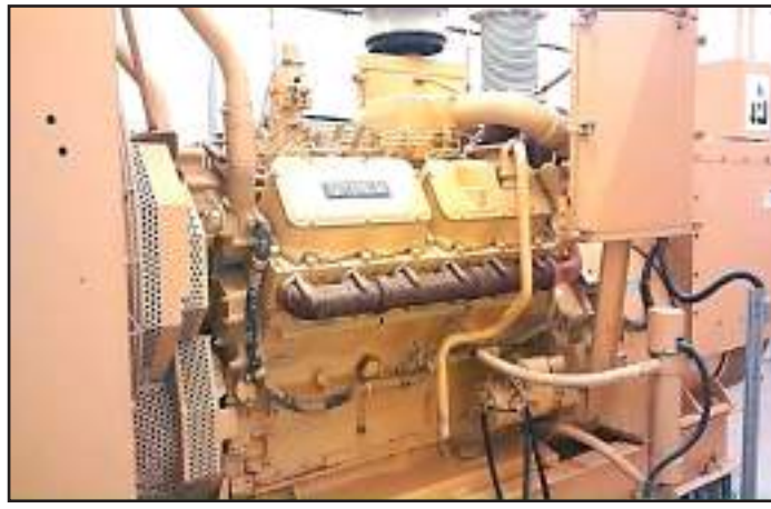
● صيانة مولد كهرباء مركز الحاسب الآلي
